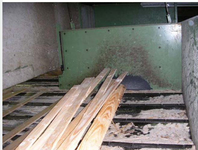
Une protection contre les chocs de liteaux en bois
